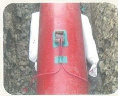
■ Mg-Line Anode for LNG Pipeline
