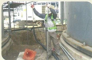
■ H.S.C.I Anode for Tank Bottom
